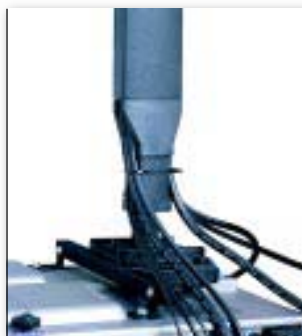
Alle Anschlusskabel lassen sich dezent in den Kabelkanälen verbergen.
